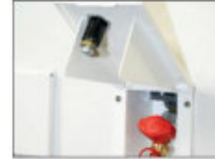
外部ガス接続口
