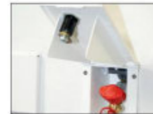
外部ガス接続部
