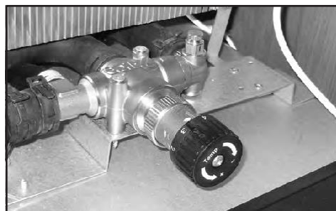
AGS II Pro床暖房は認識可能です ボイラーのそばのシャントバルブ
