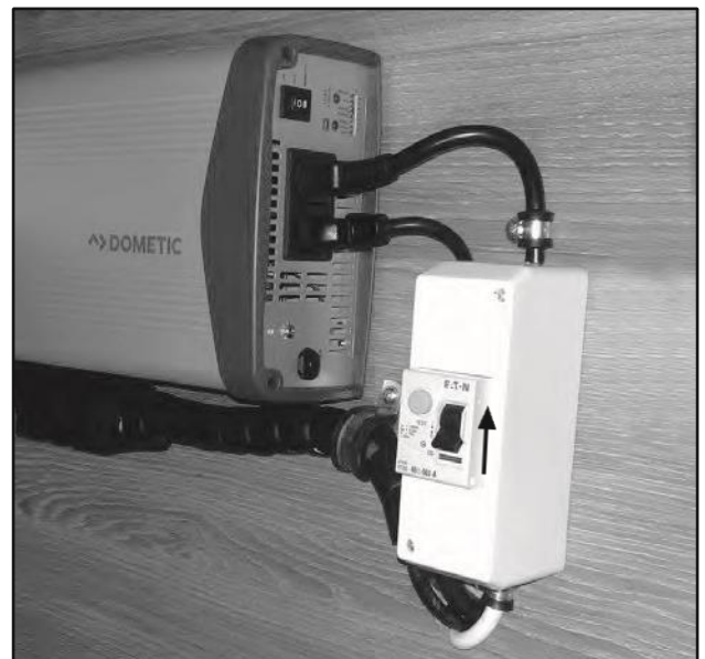
インバーターの隣に残留電流装置が取り付けられています
