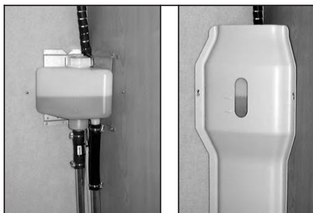
膨張タンクと点検穴付きカバープレート
