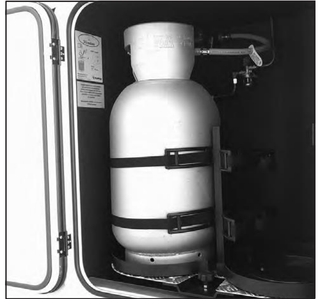
ボトルロッカーのガスボンベ
